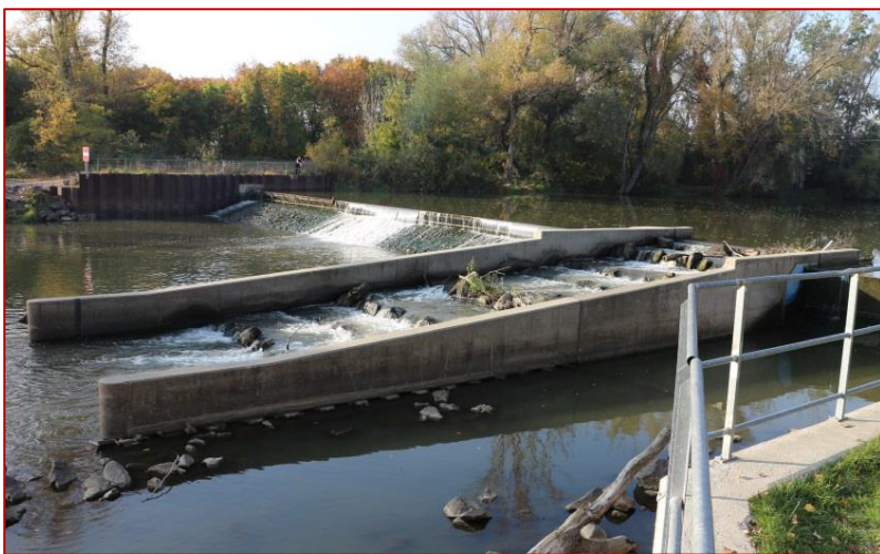
Obr. 117 Nevhodné vnútrokorytové nedostupné umiestnenie rampy, bez ochrany proti plávajúcim predmetom, s najrizikovejším typom prepážky (balvanitá mnohomedzerová).
