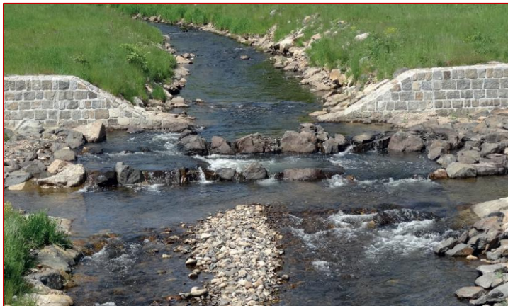
Obr. 101 Príklad spätného zatopenia (zavzdutia a spriechodnenia) stupňa pomocou niekoľkých celokorytových prepážok, prerušených priechodovou štrbinou (Musil, Marek a Barankiewicz 2020).
