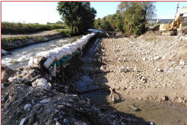
Obr. 64 Záber z výstavby ukazuje dno z riečnych kameňov aj rozmiestnenie oddychových balvanov. Vzadu pôvodná nepriechodná migračná bariéra pred spriechodnením – vodopádový riečny stupeň s prevýšením hladín cca 0,8 m.
