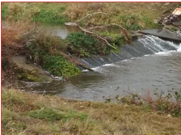
Obr. 68 Pôvodná nepriechodná migračná bariéra pred spriechodnením . Pohľad z pravého brehu.
