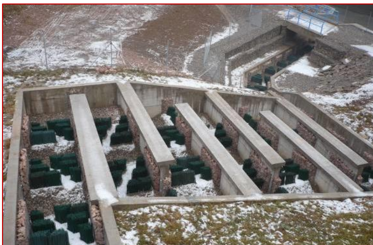
Obr. 150 Mimoriadne účinné spomaľovanie bystrinného prúdenia štetinami, ako aj opakované zalomenie trasy, umožňuje prekonanie veľkých prevýšení na malom priestore . Na tomto obrázku je rybovod pri nesprevádzkovej MVE Ružbašská Miľava na Poprade v rkm 73,7 (2013). (foto M. Macková)
