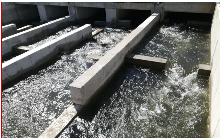
Obr. 126 Vtokový objekt s piatimi úrovňami vtoku prepojených bazénmi, zabezpečuje približne rovnaký prietok a pokojné prúdenie v bazénoch, aj v štrbinách počas všetkých cieľových hladín zdrže, rozkolísaných až o 1,5 m.
