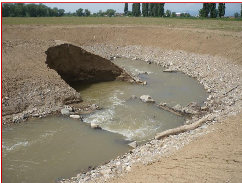
Obr. 146 Brehy koryta sú nestabilné – neopevnili ich skalami s priemerom minimálne 20 cm ako bolo v projekte. Keď sa nezrealizuje ani projektovaná ochrana vtoku proti vplávaniu plavenín inštaláciou riedkych hrabíc predsadených aspoň o 0,3 m pred vtokový otvor, ľahko sa niektorá prepážka upchá konármi a kmeňmi . V takých miestach voda prepážku obteká , v brehu vznikajú nátrže , čo ešte viac rozkolíše prevýšenia hladín. Takto nedokončené stavby rybovodu sú rýchlo nefunkčné , preto by nemali byť skolaudované. (foto S. Géci)
