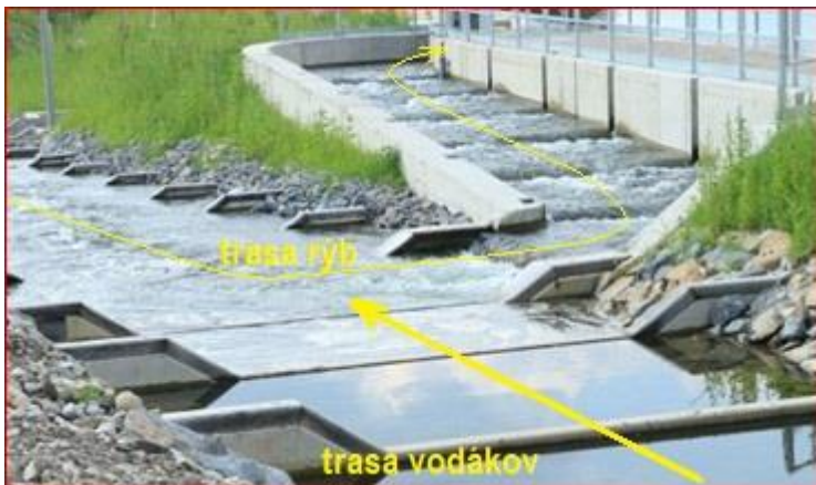
Obr. 124 Pohľad na vtok do rybovodu pre migráciu rýb (vpravo) a na vjazd pre vodákov (vpredu).
