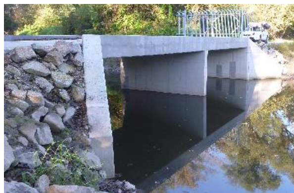
Priepust na sprietočnom devínskom ramene – umožňuje migráciu rýb a vodnej bioty
