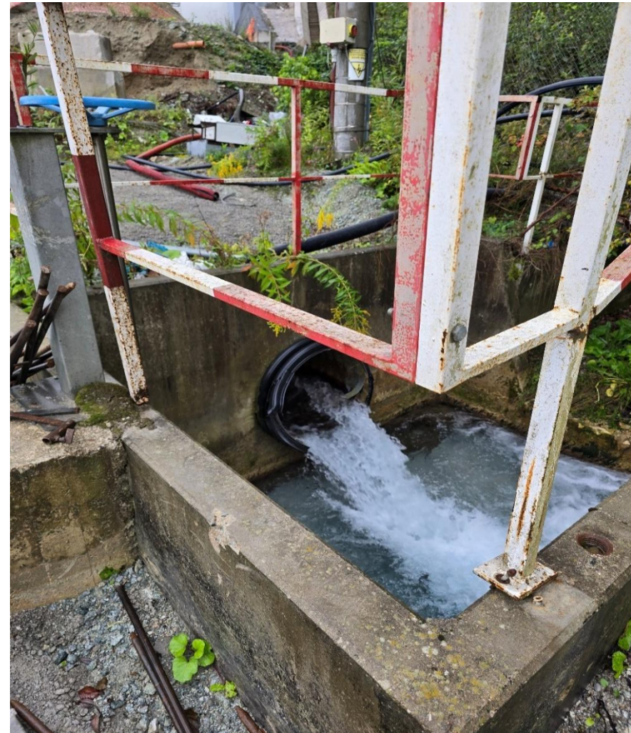
Voda vytekajúca z odvodňovacej štôlne, Archív autora
